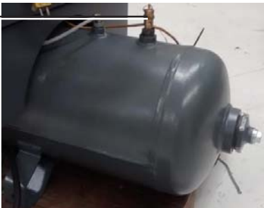
Válvula de segurança, montada sobre o reservatório
